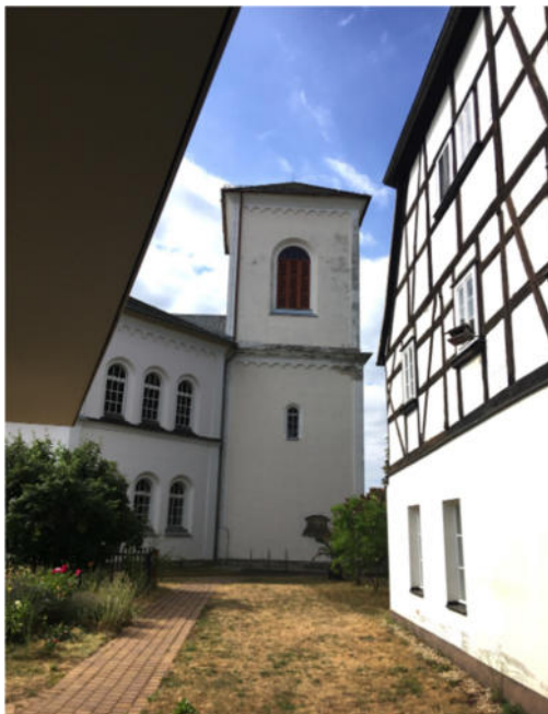
Schäden am Kirchturm, Foto Carsten Weber
